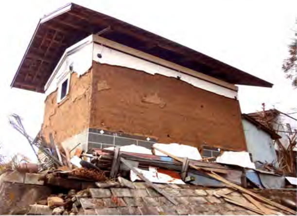
壁がはがれ落ちた土蔵。見た目以上に被害が大きいところも
